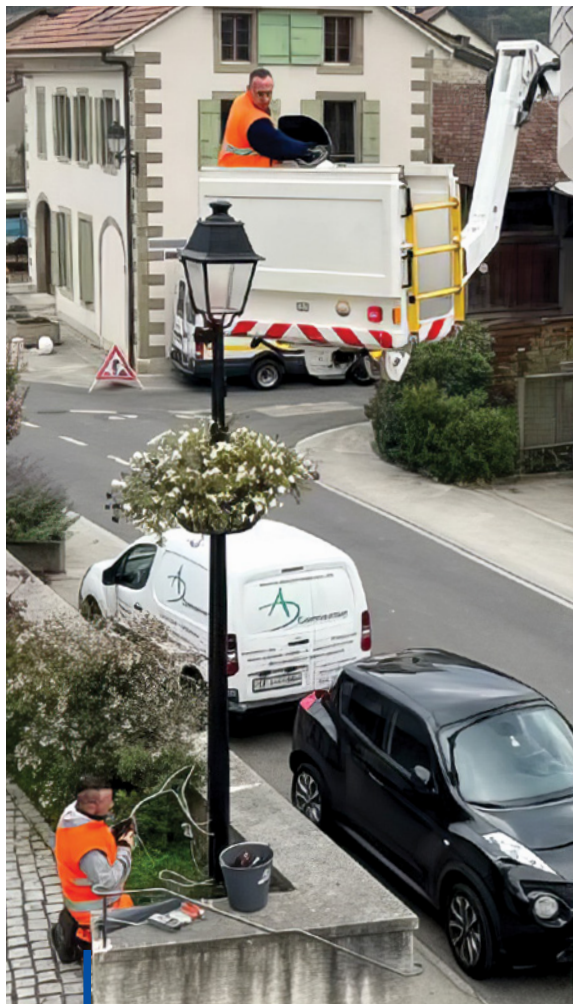
Une équipe des SIG installe un variateur.
